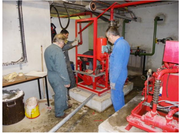
et le déplacement de la pompe électrique
