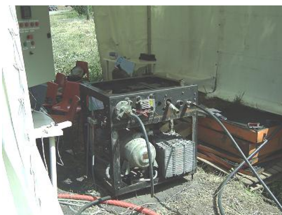
Le convertisseur gaz/électricité en fonctionnement.
